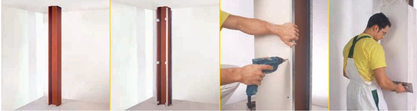
Stützenbekleidungen mit Unterkonstruktion.
